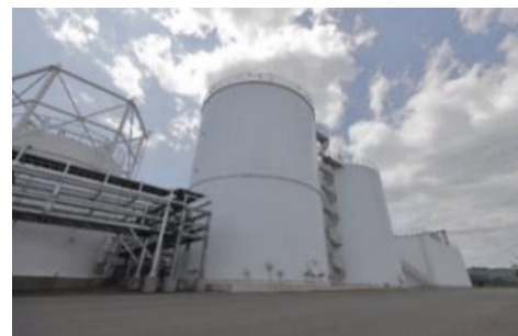
2023年5月 メタン発酵設備 稼働
